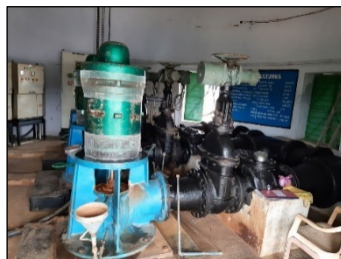
ポンプ施設 (Tiruchirappalli)
