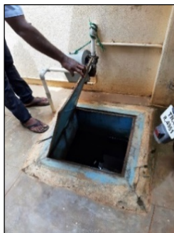
地下貯水用タンク
