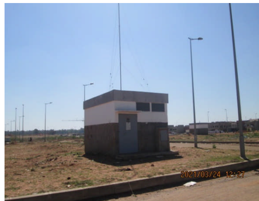
整備された変電設備
