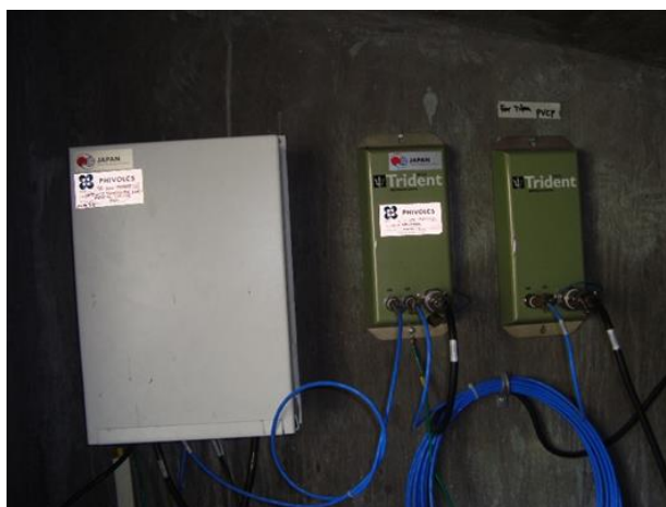
本事業で設置された地震計
