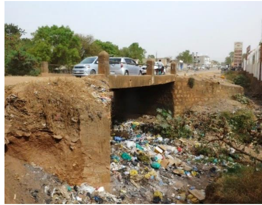
不法投棄されたゴミが堆積した川
