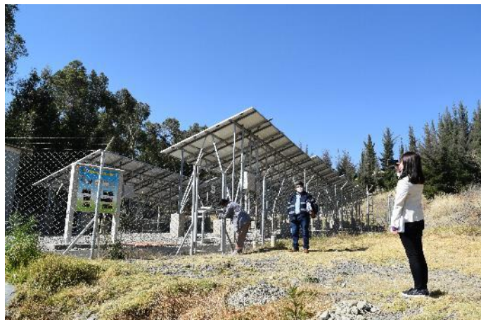
UMSA 大学構内に設置された太陽パネル
