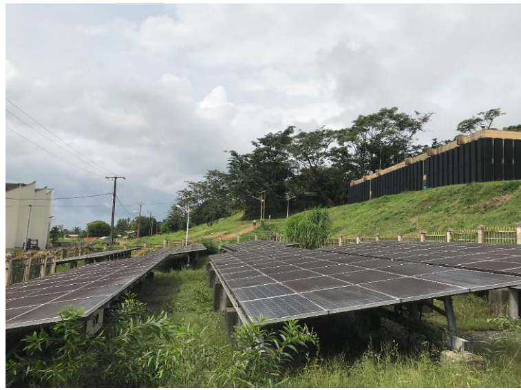
オマール・ボンゴ大学に設置された太陽電池モジュール
