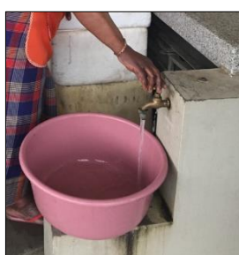
各区画に設置された水栓蛇口
