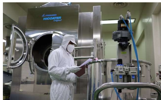
SPMC に設置された医薬品製造機材
