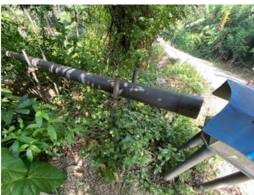
（ヌワラエリヤ・ウダマドゥラ地区の地盤伸縮計） 破損しており修理が必要
