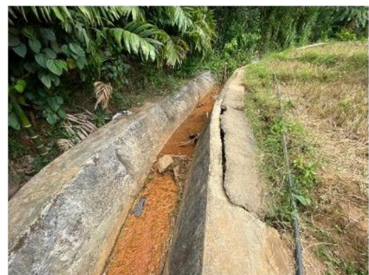
（ヌワラエリヤ・ウダマドゥラ地区の排水溝） 破損しており修理が必要
