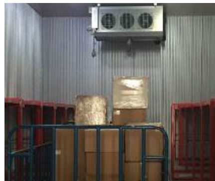
(写真右) 冷蔵施設内
