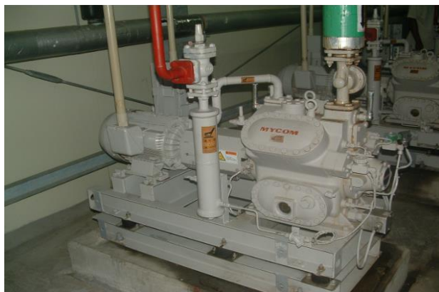
本事業で2016年にオーバーホールした、キングスタウン水産施設 の製氷機用コンプレッサー (2021年8月16日撮影)
