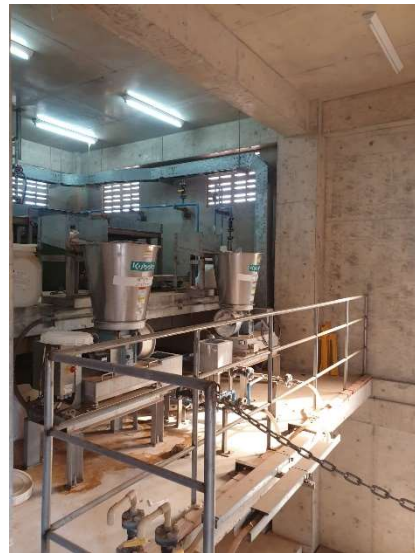
薬品注入設備
