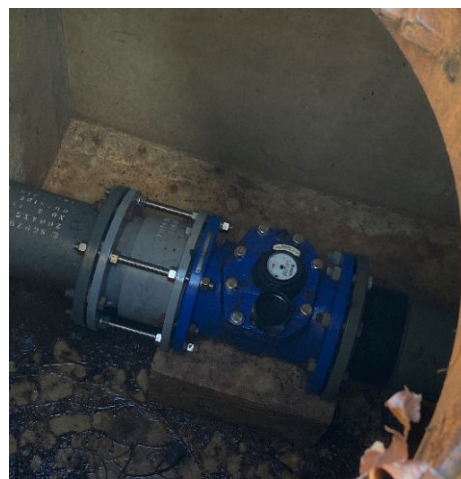
本事業で設置したゲルケソワル配水池の流量計 （出典：評価者撮影）
