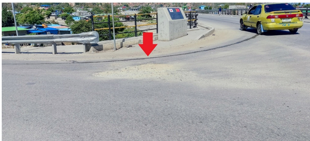
(参考) 写真 8 : 日の出橋とアクセス道路の接続付近の凹凸箇所 (凹みに砂が滞留している) (2021 年 10 月撮影)
