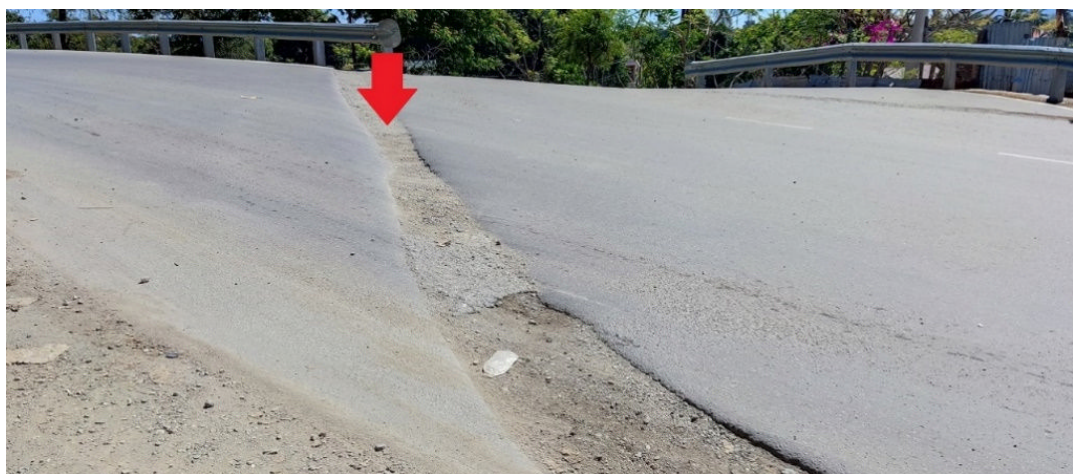
(参考) 写真 9 : アクセス道路上の凹凸箇所 (凹みが発生している) (2021 年 10 月撮影)
