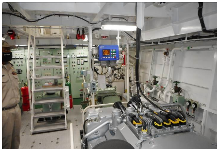
右機関（右下）とそのコントロールパネル（奥）
