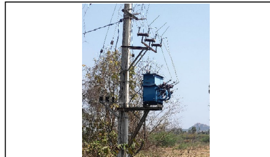
小容量変圧器
