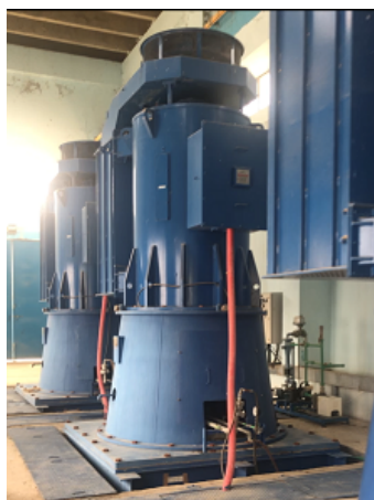
本事業で整備された排水ポンプ (出典：事後評価チーム)
