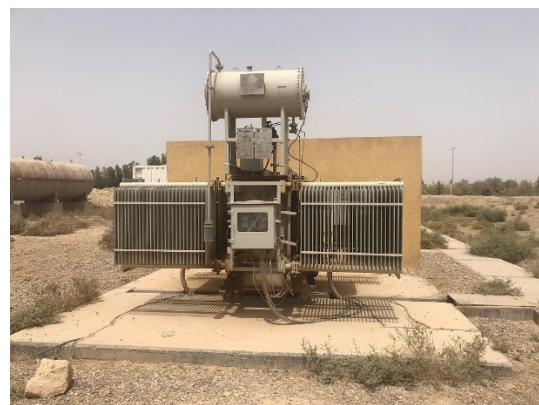
本事業で整備された電力変圧器 (出典：事後評価チーム)
