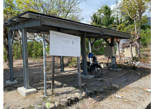
アタウロ基礎学校に設置された太陽光発電独立型システム (本施設の屋根部分は太陽光パネルである。)
