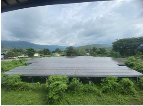
UNTL 工学部ヘラ・キャンパスに設置された太陽光発電系統連 系システム
