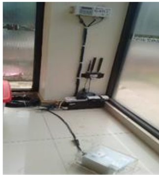
IT 震度計設置状況
