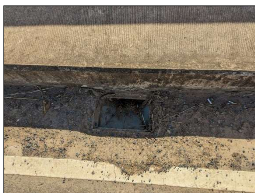
主橋梁の排水口 (蓋がなくなっている)
