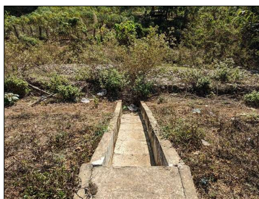
アプローチ道路の排水溝 (雑草とごみで埋まっている)
