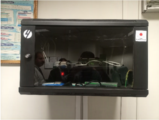
写真5：気象データ用基幹通信システム（一部） （PMD ラホール洪水予報局） （出典：現地調査補助員撮影）
