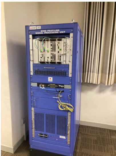
写真1：ウィンドプロファイラシステム (一部) (PMD イスラマバード気象観測レーダー塔内部) (出典：評価者撮影)
