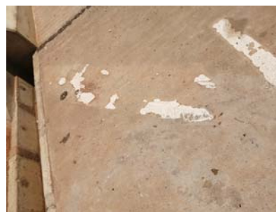
路面のマーキングの剥離 (出所：現地調査)
