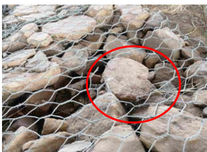
護岸工の蛇かごの金網の破損 (出所：現地調査)
