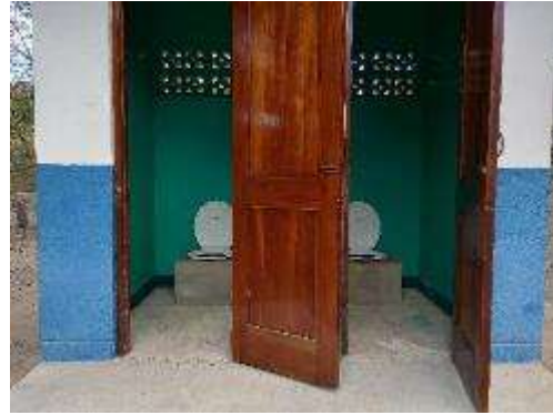
写真8 本事業で整備された便所（ヌエバ・セゴビア県）
