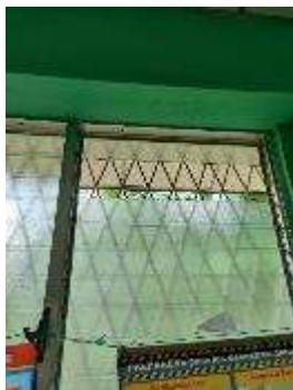
写真 14 窓ガラス板の欠損 (ヌエバ・セゴビア県)
