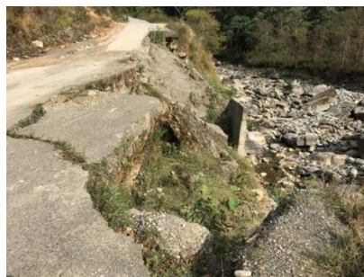
写真7 ラングルン河橋地点のアプローチ道路と擁壁一部の崩落箇所 （出典：外部評価者）
