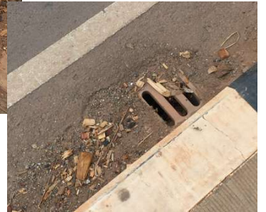
歩道の伸縮部分の充填剤の盗難
