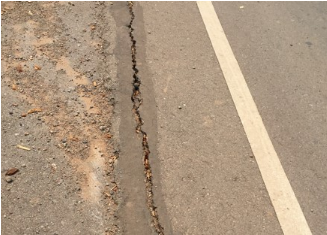
アプローチ道路の亀裂 (セタームアック橋)
