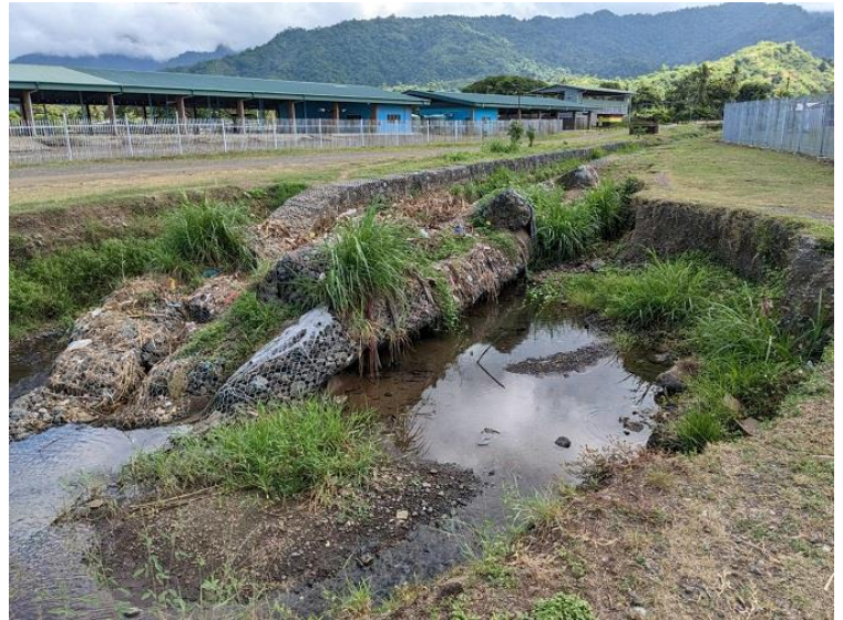
豪雨により浸食した小河川（出典：外部評価者）
