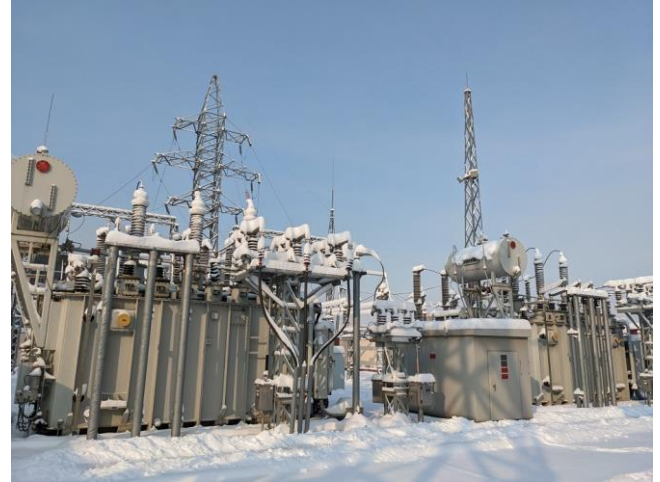
本事業で整備したラディオスタンツィヤ変電所
