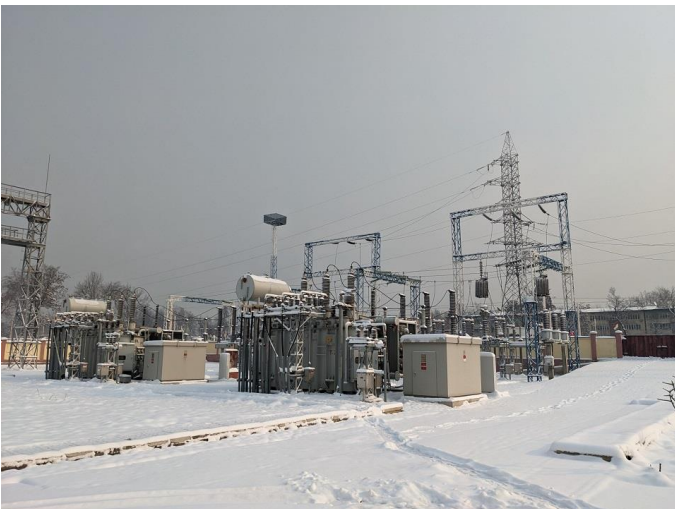
プロミシレンナヤ変電所にて整備した変電設備 (出典：外部評価者撮影)
