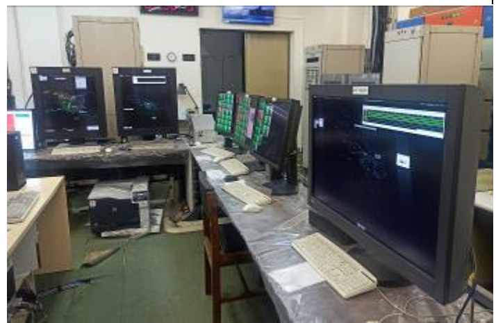
本事業は、無償資金協力「トリブバン国際空港近代化計画」で調達された監視システムを強化し、システムは航空路レーダー管制業務の提供に使われている。
