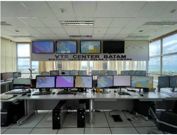
VTS Batam コントロール室
