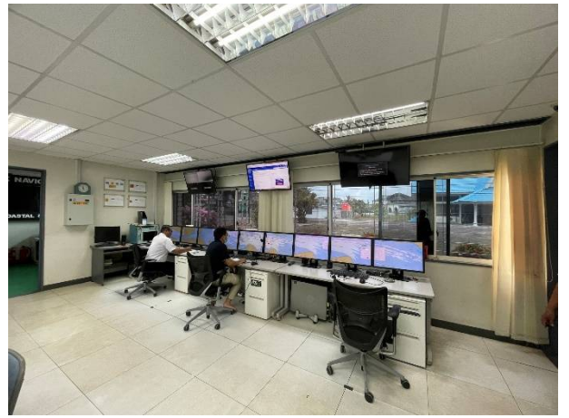
VTS ドマイ コントロール室
