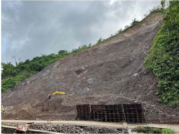
RO VII 斜面崩壊現場
