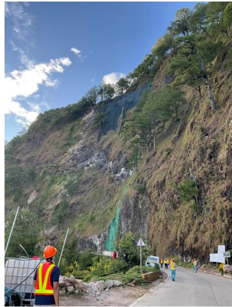
RO CAR 斜面崩壊現場
