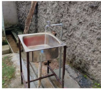
学校に据え付けられた水飲み場
