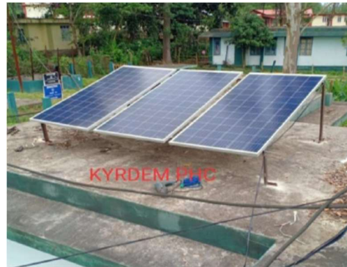
一次医療センターに据え付けられた太陽光発電パネル（出典：NITI Aayog）
