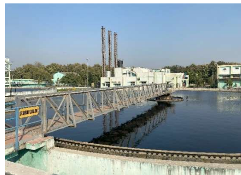
本事業で建設した下水処理施設 (評価者が撮影)
