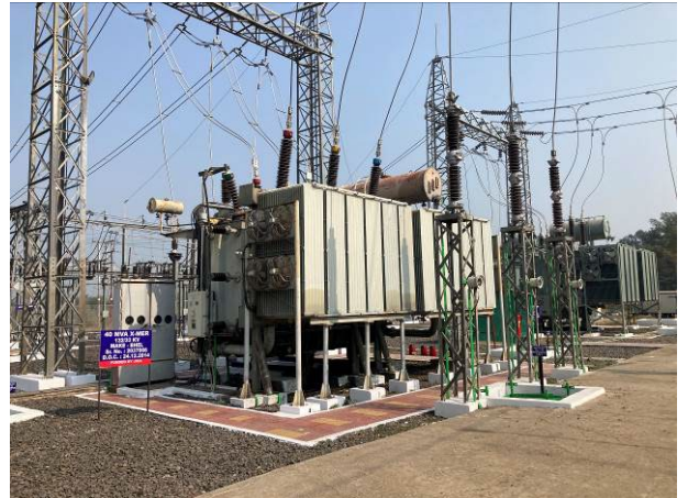
本事業の変圧器（手前）・後に増設された変圧器（後方） (ジャバルプール変電所：外部評価者撮影)
