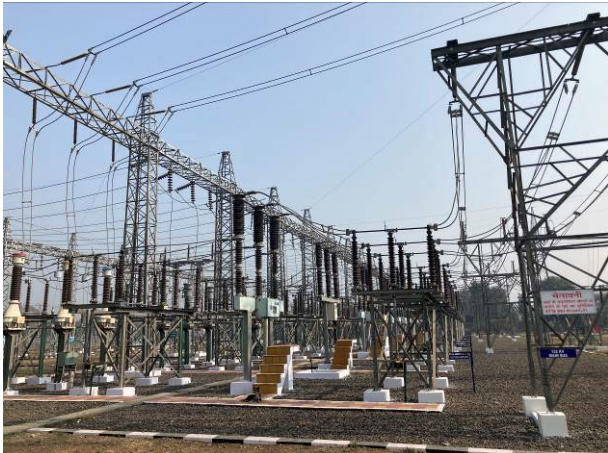
変電所の開閉器 (ジャバルプール変電所：外部評価者撮影)
