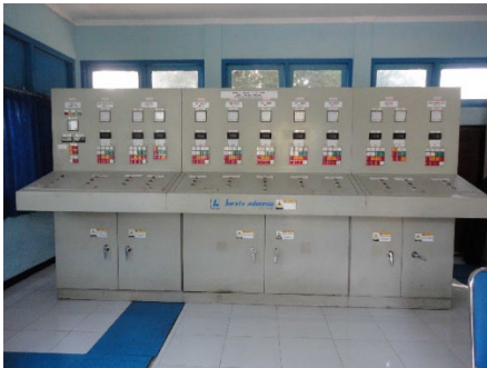
ボジョネゴロ堰の水門制御室 (出典：評価者)
