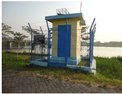
ボジョネゴロ堰付近に設置されたFFWS (出典：評価者)
