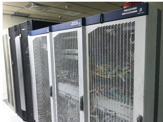
写真1：アル・マムーン（Al-Mamoon）サイト 通信機器格納棚（出典：事後評価チーム 1 ）
