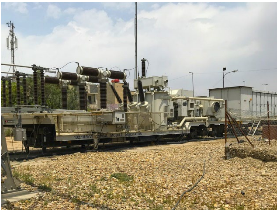
移動式変電所
