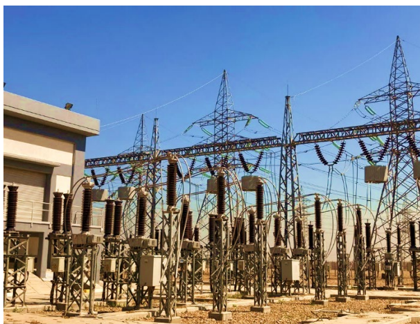
新設された変電所（バグダッド郊外） 1
