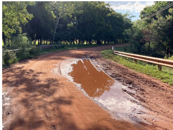
轍に水がたまった砂利舗装区間
