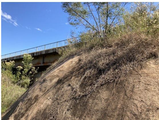
橋梁護岸で成長した樹木
