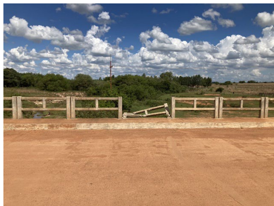
橋梁防護柵の損傷
