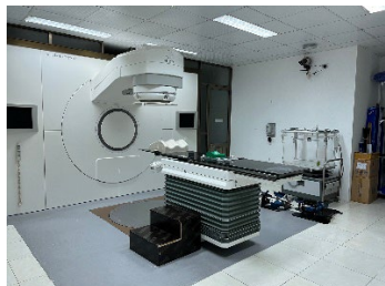
写真 2 ダナン中央総合病院に設置された放射線治療機器
