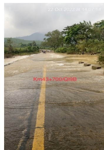
写真 4: 未改修橋梁（本事業対象外） における冠水の様子（クアンビン省） （出典：クアンビン省 DOT）
