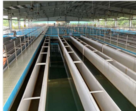
タンヒエップ浄水場の凝集設備 (出所：評価者撮影)
