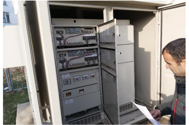
国立医療センターのコントロールパネル
