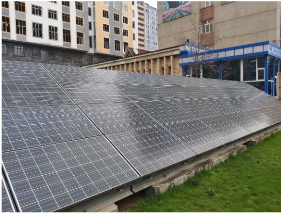
SRIOGP に設置された太陽光発電システム
