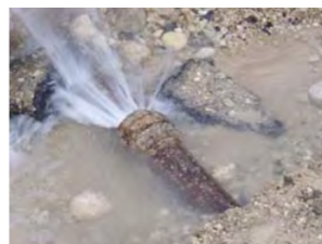
写真 2: 管の継ぎ手破損による漏水
