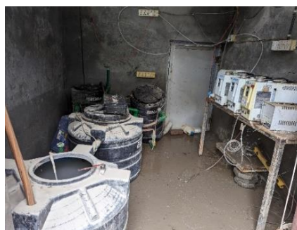
ジャワガル LCD 水処理システムの水素ガス発生器は、洪水による浸水被害で故障している
