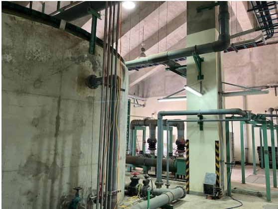
施設内の散水ろ床 (出典：評価者撮影)
