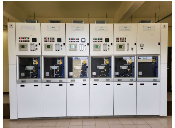
写真 6：カブガ開閉所 15kV 配電盤 (出典：評価者撮影)
