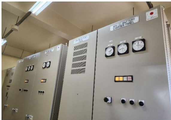
写真 3：カブガ開閉所内用電源設備 (出典：評価者撮影)
