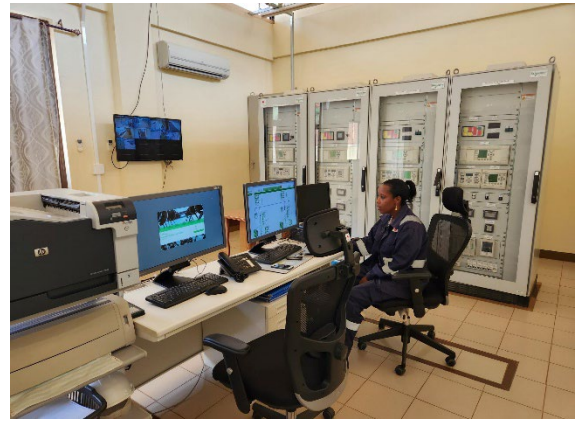
写真 2：ンデラ変電所コントロールルーム (出典：評価者撮影)
