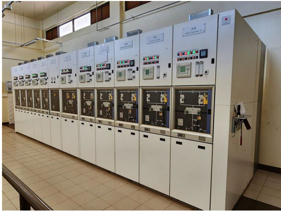
写真 1：ンデラ変電所 15kV 配電盤 (出典：評価者撮影)
