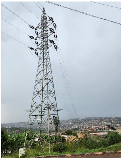
写真 5：15kV 配電線 (出典：評価者撮影)
