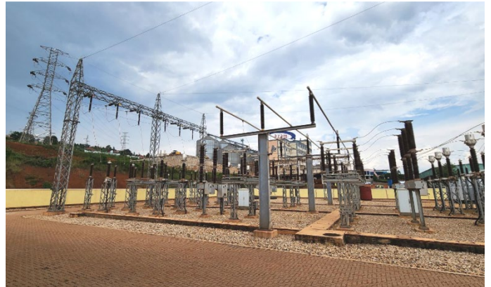
ンデラ変電所 110kV 開閉設備 (出典：評価者撮影)
