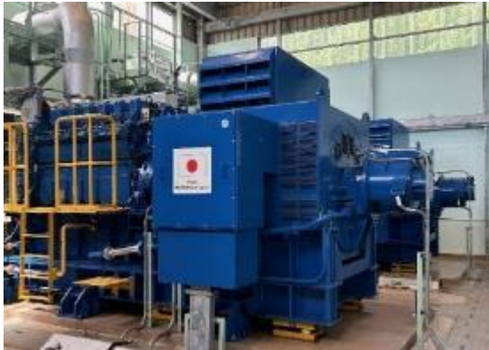
写真1：トフォル発電所に設置された発電機 (出典：外部評価者)
