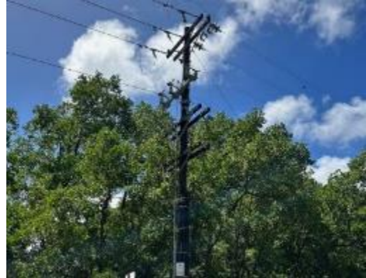
写真2：地中ケーブル接続ポール (出典：外部評価者)
