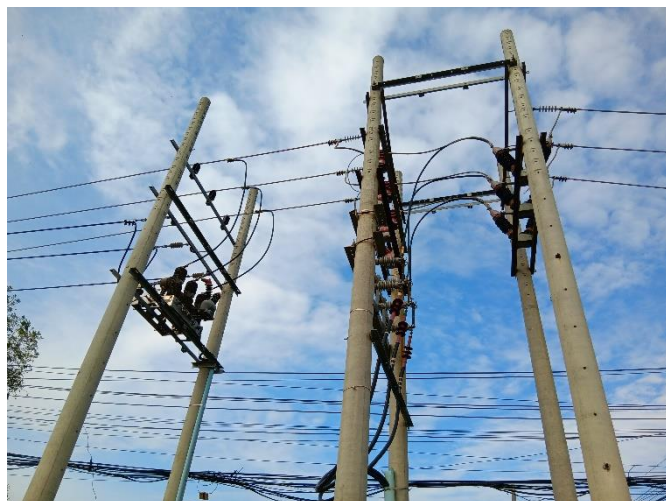
国道 1 号線沿いの本事業で整備した配電線
