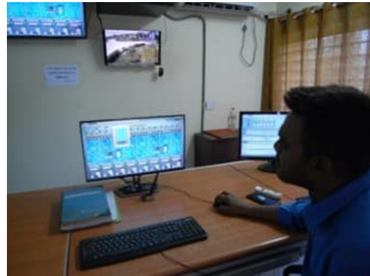
写真 6. 浄水場内の中央制御室及び SCADA オペレーター（リーダー）（2024 年 4 月、評価者撮影）
