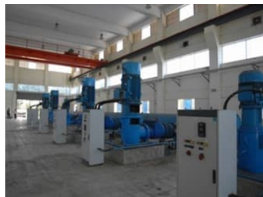
写真 2. 浄水場の送水ポンプ（2024 年 4 月、評価者撮影）
