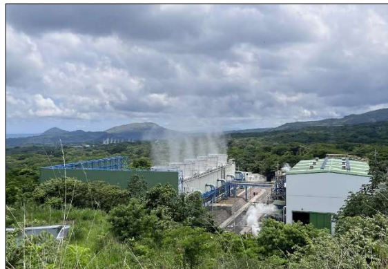
ラス・パイラス II 地熱発電所
