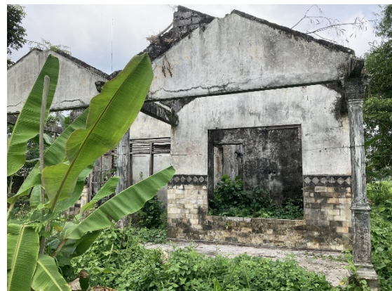
写真 6：2010年11月の噴火と土石流により破壊された家屋 (ゲンドール川の遊砂地近くに遺跡公園として整備されている) (出典：評価者撮影)
